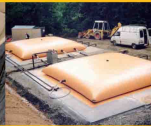
▪ Réservoir de récupération d'eau de pluie
